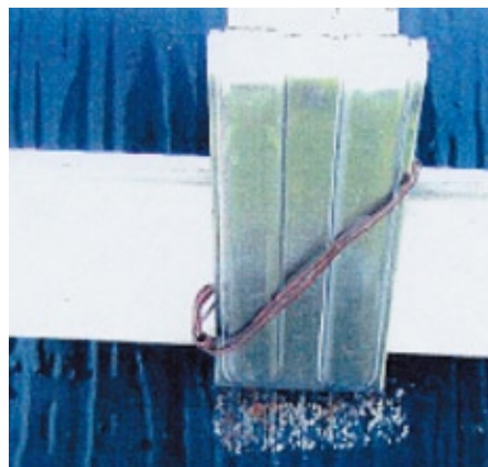
●銅線とカラー鋼板の接触
